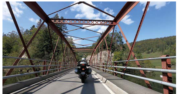
Die Brücke bei Biaufond hat den grenzüberschreitenden Handel vereinfacht und ist heute noch ein besonderer Blickfang. Foto: Martin Eberle
